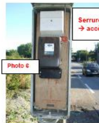
Coffret sur poteau, ouvert
