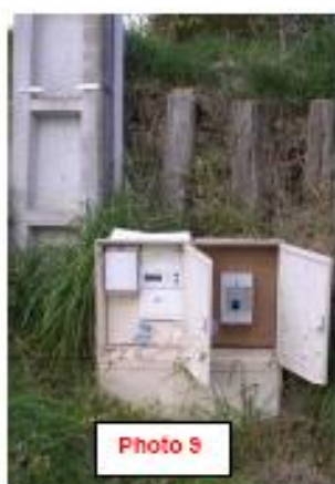
Compteur et disjoncteur dans coffrets extérieurs (généralement dos à dos)
