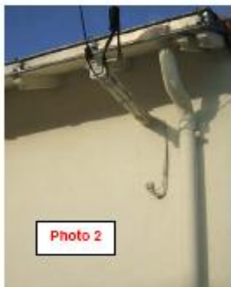
Câble de branchement, vu de près
